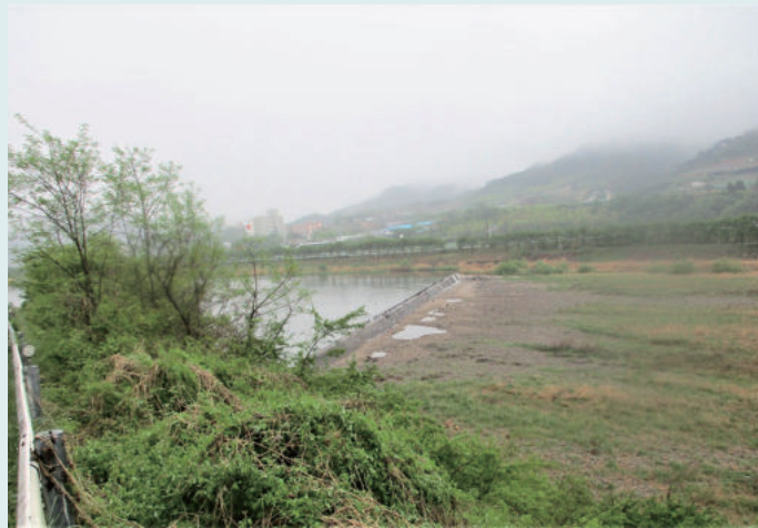
200m에 이르는 ‘거평보’의 현재 모습. 원래는 소나무 등으로 만들었으나 40여 년 전에 시멘트로 교체했다. 심청 할아버지의 벽절정에서 가까운 곳이다.
